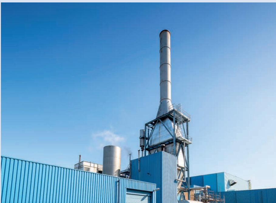
De warmtekrachtcentrale is in 2017 gereviseerd en deels gemoderniseerd.
